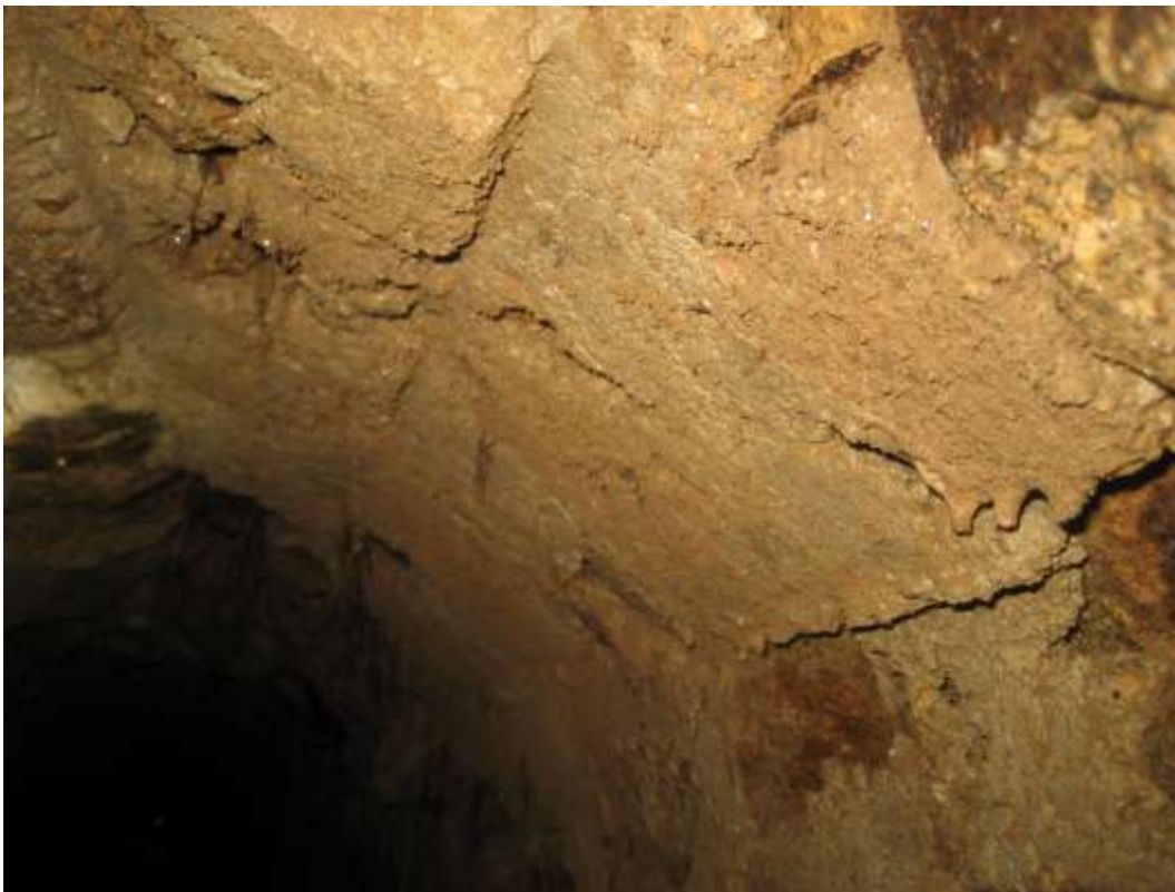
Traces de coffrage sur la voûte.
