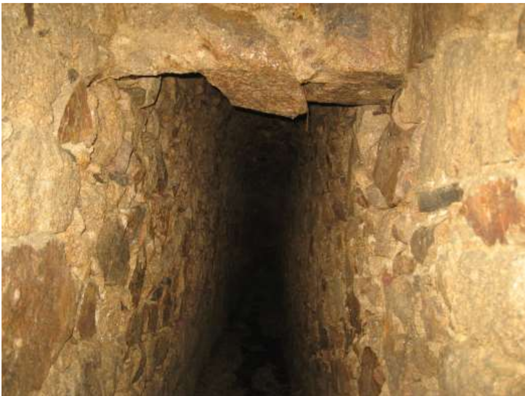
Arrivée au niveau de la cheminée n°3.
