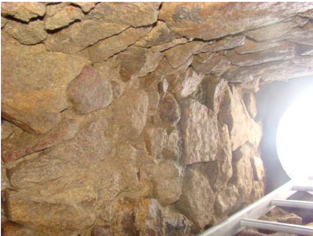
Vue de la cheminée d'accès depuis le fond. Dimensions : 0,60m.x 0,60m. x 1,20m.
