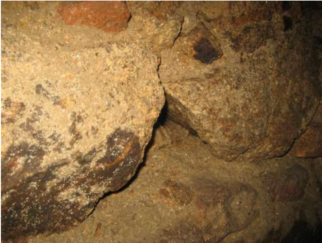
Passage pour l'écoulement de surface, présence d'une brique dans le parement.
